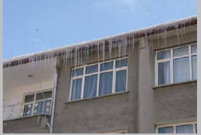
Çatı saçaklarında oluşan buzlar son derece tehlikeli yaralanmalara sebep olabilmektedir.
