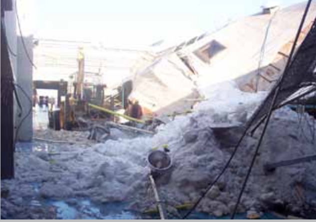
Kar ağırlığı hasarı yaşamış bir tesisin genel görüntüsü
