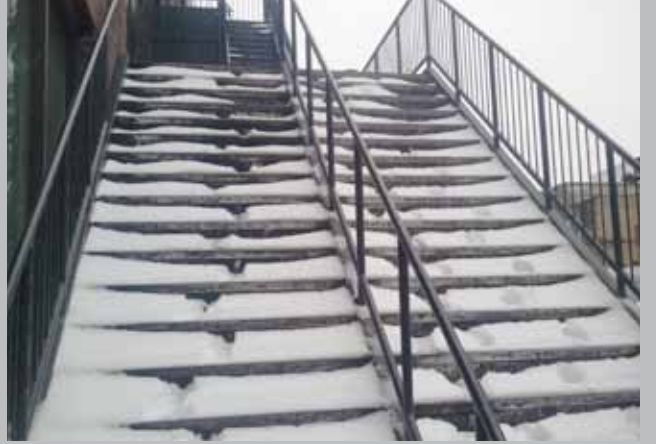
Özellikle sabahları temizlenmemiş merdivenler çok ciddi kazalara ve yaralanmalara yol açabilmektedir.
